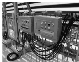
ゴンドラの操作盤
